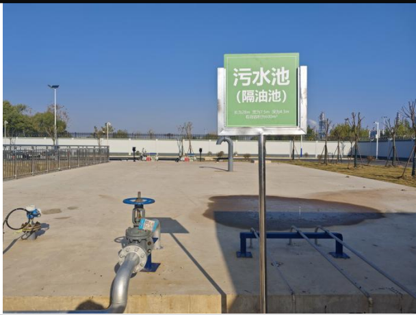
隔油池及生产污水/初期雨水提升池
