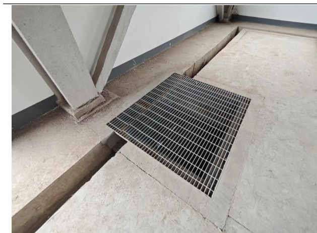
导流沟及防泄漏收集池
